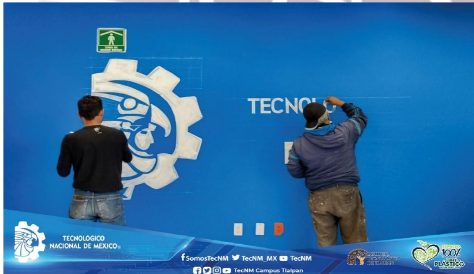
Figura 23. Rotulación de subestación eléctrica
